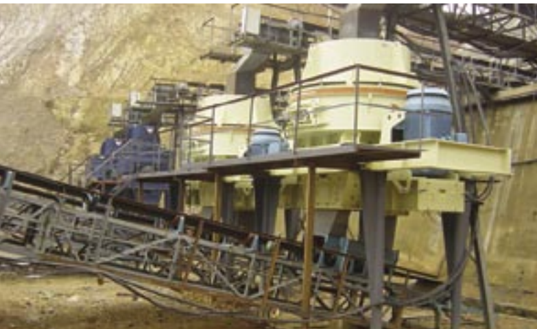
Четыре дробилки Barmac на производстве высококачественного песка и заполнителей.
